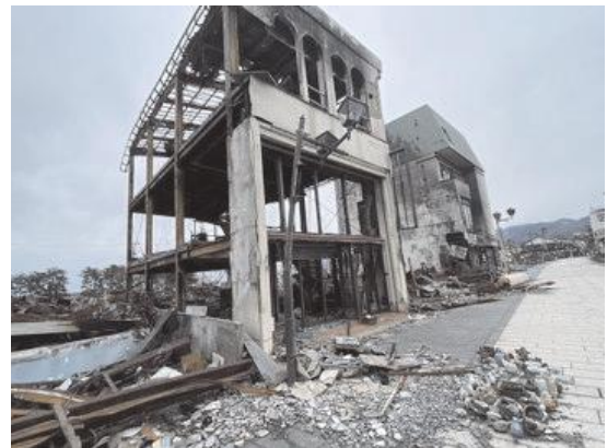
写真 4 朝市全体が延焼し被災した
